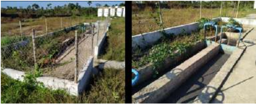
Figura 6 e 7: Caixas de gradeamento, caixas de areia, caixas de gordura
