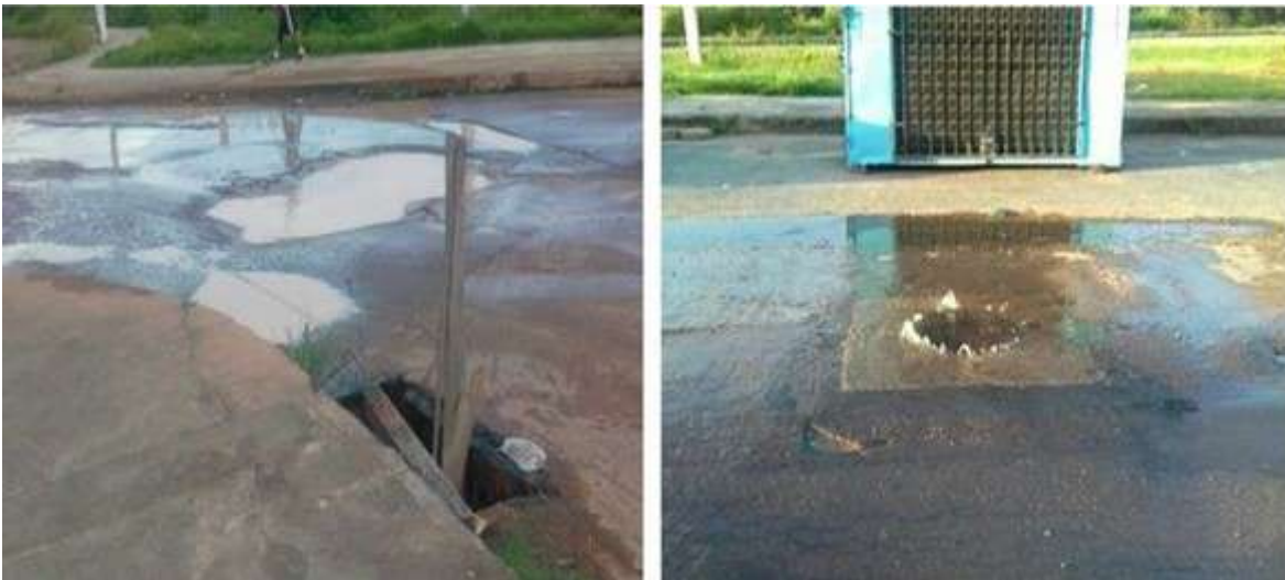
Figura 5 e 6: Vazamento e transbordamento dos PV's
