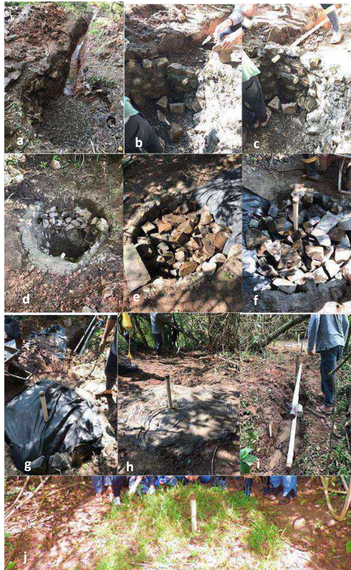
Figura 3 – ilustração das etapas da implementação do sistema caxambú. (a) revestimento do fundo com brita e drenagem da água acumulada; (b, c) montagem da represa com os canos de drenagem, captação e de transbordo; (d) revestimento da borda da nascente com massa solo\cimento; (e) preenchimento da nascente com pedras; (f) instalação do cano de sanitização. (g) cobertura da nascente com manta geotêxtil (h) vedação da nascente com massa solo\cimento; (i) proteção da saída dos canos com malha de nylon e (j) cobertura da nascente com solo e gramínea local. Fonte: Autores (2022)
