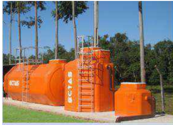
Figura 2: Estação de Tratamento de Esgoto Compacta
