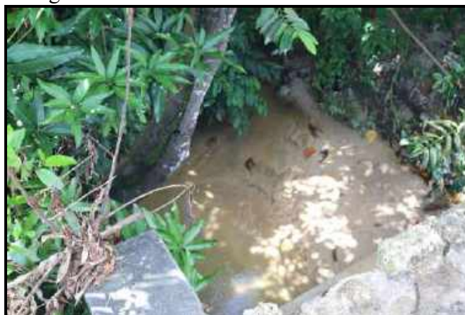
Figura 4 - Canal de drenagem assoreado
