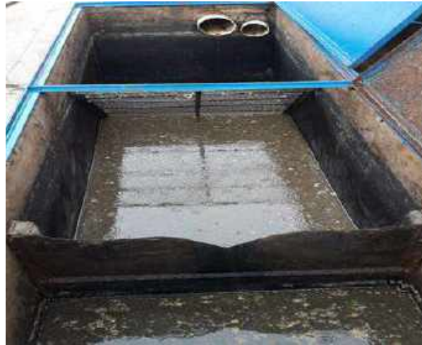
Figura 4: Caixa de decantação de efluente do abatedouro. Fonte: autoria própria.
